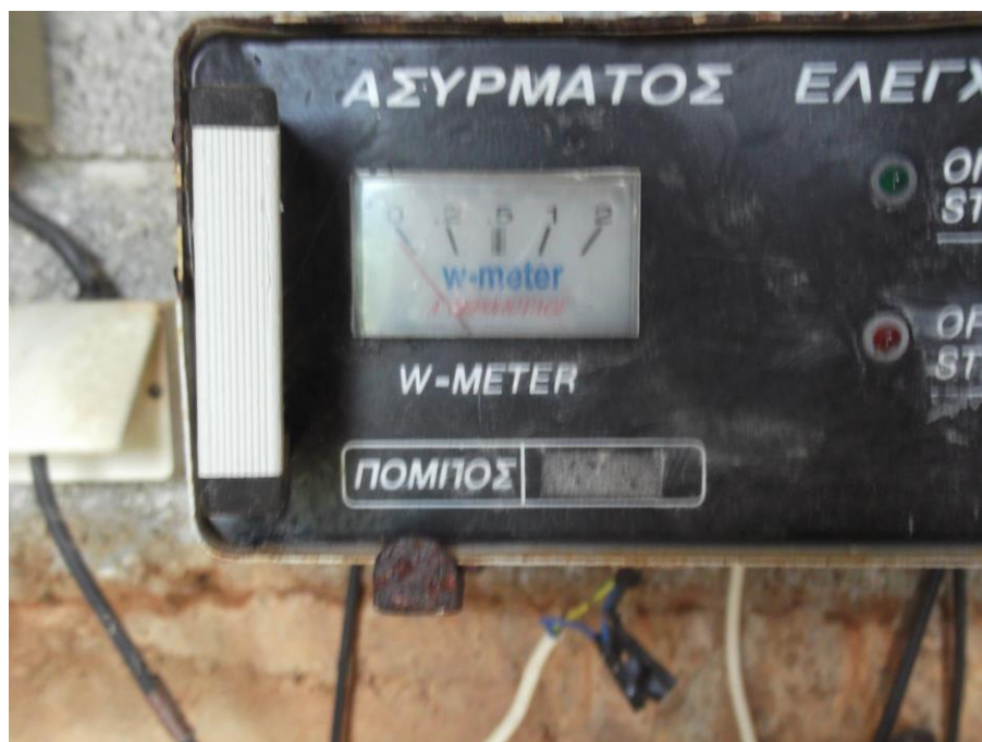
Φωτ. 14: Διάταξη ελέγχου στάθμης της Δεξαμενής εντός του οικίσκου χλωρίωσης - αυτοματισμών - ελέγχου στάθμης της Δεξαμενής Μικροκάστρου
