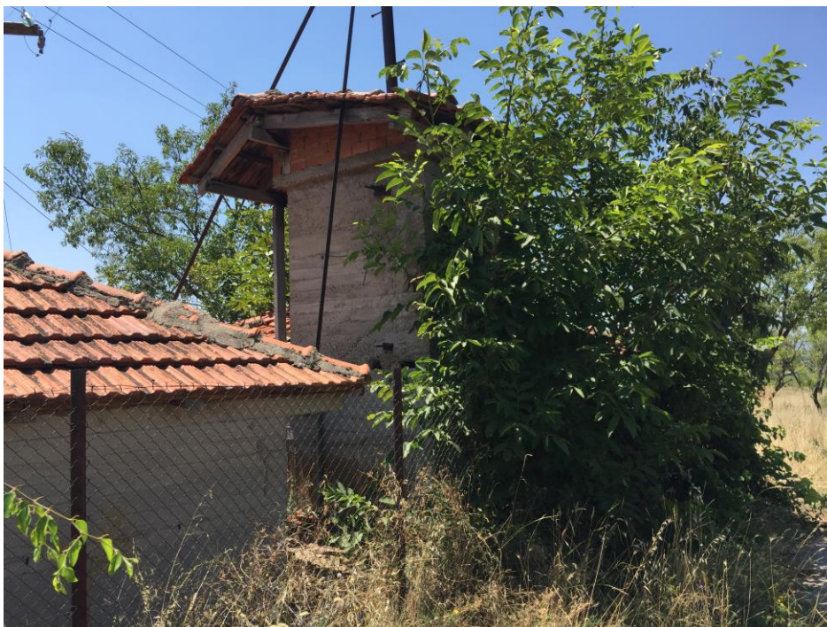
Φωτ. 17: Άλλη Εξωτερική άποψη Αντλιοστασίου Κατσέλη. Λήψη από την ασφαλτοστρωμένη Δημοτική οδό πρόσβασης στο Α/Σ. Διακρίνεται αριστερά της λήψης ο οικίσκος του Γενικού Πίνακα Χαμηλής Τάσης και στα δεξιά της λήψης η Δεξαμενή αναρρόφησης του Αντλιοστασίου και ο οικίσκος άνωθεν αυτής για τον έλεγχο της Δεξαμενής μέσω φρεατίου, κατά τη συντήρησή της.
