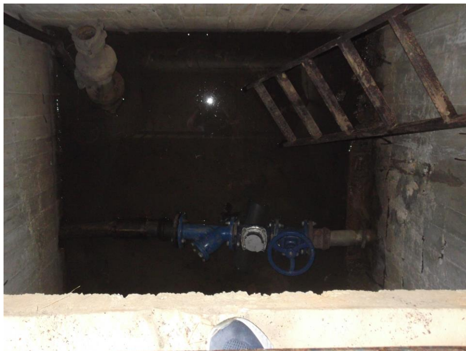
Φωτ. 13: Άνοψη του υφιστάμενου απαγωγού υδροδότησης του οικισμού Μικροκάστρου στη θέση εξόδου του από τον υγρό θάλαμο της Δεξαμενής. Διακρίνονται ο Χ/Σ Φ100mm που εξέρχεται από τον υγρό θάλαμο της Δεξαμενής (δεξιά της λήψης), η δικλείδα απομόνωσης, το παροχόμετρο, το φίλτρο νερού, και το φλαντζοζιμπώ σύνδεσης με τον πλαστικό αγωγό υδροδότησης του οικισμού (αριστερά της λήψης).
