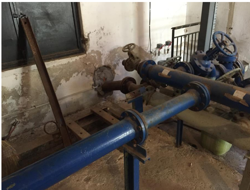
Φωτ.57: Άποψη του καταθλιπτικού αγωγού το εσωτερικού του Βανοστασίου του Α/Σ Σφαγείων, κατόντη των αντλιών και των συλλεκτών μέσω του οποίου μεταφέρεται ωθητικά νερό στην Δεξαμενή Δ5 της Σιάτιστας (Μεσαία Ζώνη)
