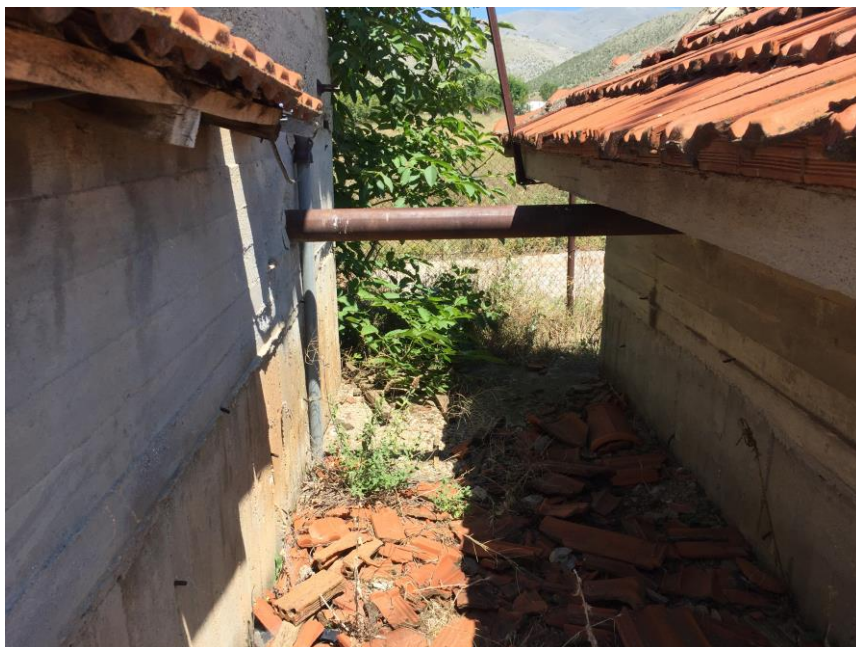
Φωτ.25: Εξωτερική κοντινή άποψη του Αντλιοστασίου από τον περιβάλλοντα χώρο. Διακρίνεται στα αριστερά της λήψης η Δεξαμενή αναρρόφησης και ο οικίσκος ελέγχου και συντήρησης της Δεξαμενής άνωθεν αυτής. Στα δεξιά της λήψης διακρίνεται η κεραμοσκεπή και ο οικίσκος του Γενικού Πίνακα Χαμηλής Τάσης. Επίσης στο μέσον της λήψης διακρίνεται ο σωλήνας υπερχείλισης της Δεξαμενής ή ο καταθλιπτικός αγωγός (αγωγός κατάθλιψης) κατόπιν των αντλιών. Στο μέσον της λήψης διακρίνεται η υποβαθμισμένη πλάκα επικάλυψης του Βανοστασίου της Δεξαμενής.
