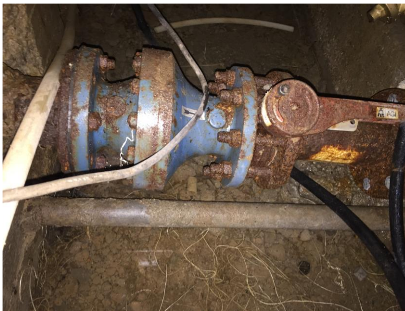
Φωτ.34: Κοντινή Αποψη της βαλβίδα αντεπιστροφής ελαστικής έμφραξης και της δικλείδας τύπου πεταλούδας για την απομόνωση του του καταθλιπτικού αγωγού (σιδηροσωλήνας Φ90μμ) εντός του Βανοστασίου του Αντλιοστασίου Κατσέλη, που εξέρχεται από τον υγρό θάλαμο της Δεξαμενής και οδεύει προς τον οικίσκο του Γενικού Πίνακα Χαμηλής Τάσης για να συνδεθεί με τον πλαστικό αγωγό Φ140μμ (PVC) κλάσης 16atm.
