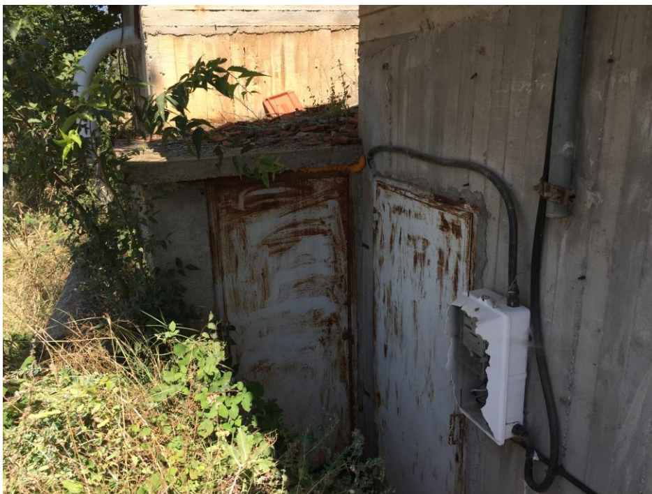
Φωτ.23: Πλησιέστερη Εξωτερική λήψη της μεταλλικής θύρας εισόδου στο υπόγειο Βανοστάσιο και της θύρας εισόδου στον υπόγειο οικίσκο Γενικού Πίνακα Χαμηλής Τάσης του Α/Σ. Λήψη από τον περιβάλλοντα χώρο του Α/Σ Κατσέλη. Στα δεξιά διακρίνεται και η παροχή ρεύματος του Αντλιοστασίου
