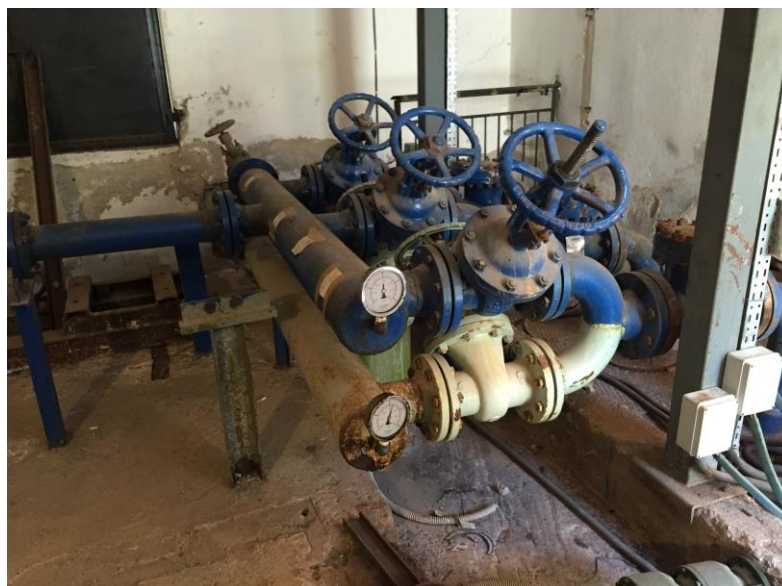
Φωτ.54: Εσωτερική άποψη των υδραυλικών διατάξεων των καταθλιπτικών αγωγών μεταφοράς νερού από το Α/Σ Σφαγείων (υψόμετρο 807μ.) στην Δεξαμενή Δ5 της Σιάτιστας (υψόμετρο 980μ.) για την κάλυψη της υψηλής ζώνης και του υπόλοιπου οικισμού. Διακρίνονται οι συλλέκτες και οι δικλείδες ελαστικής έμφραξης επί αυτών.
