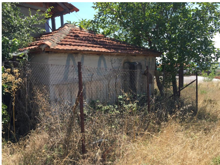
Φωτ.29: Εξωτερική κοντινή άποψη του Αντλιοστασίου Κατσέλη από τον περιβάλλοντα χώρο. Διακρίνεται η Δεξαμενή αναρρόφησης με την επικάλυψη της από κεραμοσκεπή. Επίσης διακρίνεται ο καταθλιπτικός αγωγός υδροδότησης της Δεξαμενής (Φ140μμ PVC) από το Αντλιοστάσιο της Γιάνκοβη.
