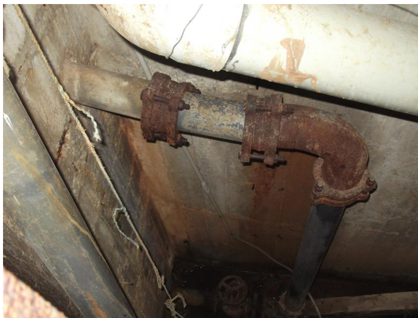
Φωτ. 12: Άλλη Άποψη του υφιστάμενου μεταλλικού σωλήνα υπερχειλίσης της Δεξαμενής του Μικροκάστρου, που συνδέεται με την εκκένωσή της Δεξαμενής, εντός του Βανοστασίου της
