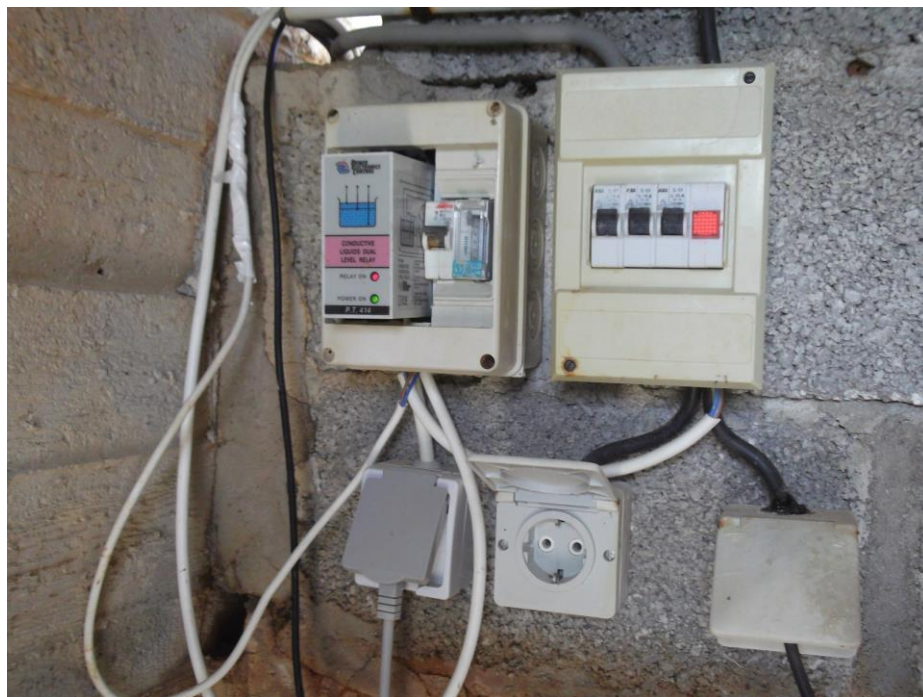
Φωτ. 15: Άποψη των πινάκων ρευμάτων - αυτοματισμών εντός του ισόγειου οικίσκου χλωρίωσης - έλεγχου αυτοματισμών της Δεξαμενής Μικροκάστρου
