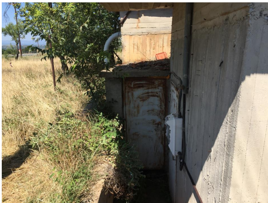
Φωτ.22: Εξωτερική άποψη της μεταλλικής θύρας εισόδου στο υπόγειο Βανοστάσιο και της θύρας εισόδου στον υπόγειο οικίσκο Γενικού Πίνακα Χαμηλής Τάσης του Α/Σ. Λήψη από τον περιβάλλοντα χώρο του Α/Σ Κατσέλη
