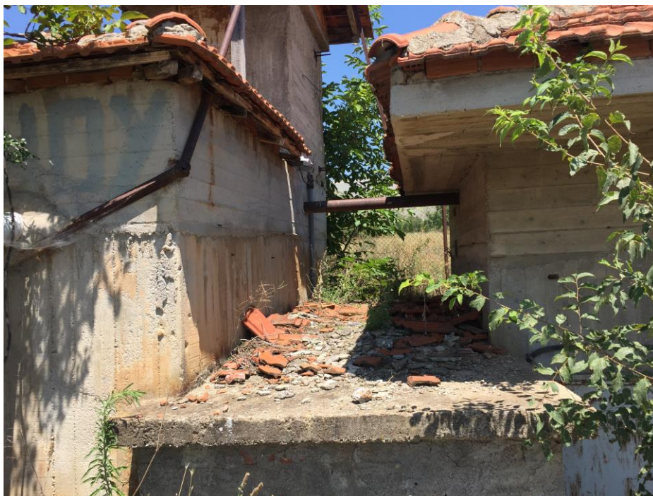
Φωτ.26: Εξωτερική κοντινή άποψη του Αντλιοστασίου από τον περιβάλλοντα χώρο. Διακρίνεται στα αριστερά της λήψης η Δεξαμενή αναρρόφησης και ο οικίσκος ελέγχου και συντήρησης της Δεξαμενής άνωθεν αυτής. Στον κέντρο της λήψης διακρίνεται η υποβαθμισμένη πλάκα επικάλυψης του
