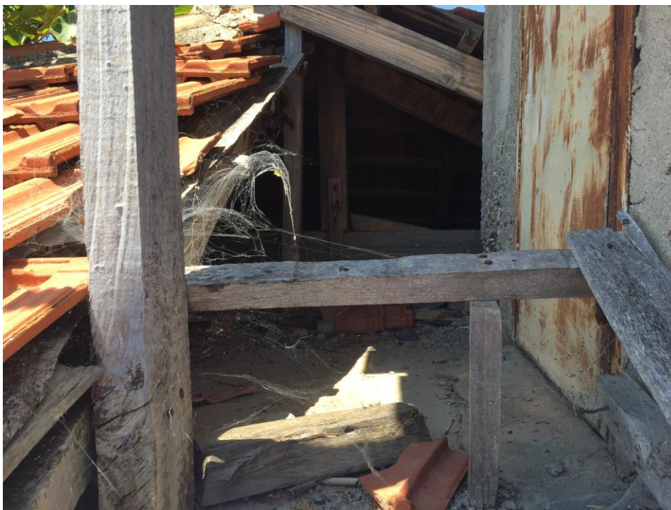
Φωτ.30: Κοντινή λήψη του φέροντα οργανισμού της ξύλινης κεραμοσκεπής επί της πλάκας επικάλυψης της Δεξαμενής αναρρόφησης του Α/Σ Κατσέλη. Στα δεξιά της λήψης διακρίνεται η μεταλλική θύρα εισόδου στον οικίσκο της Δεξαμενής
