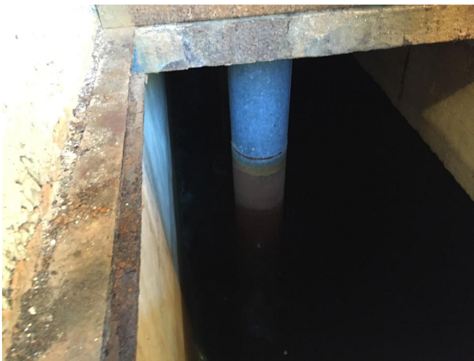
Φωτ.56: Άποψη της Δεξαμενής αναρρόφησης του Α/Σ Σφαγείων των υδραυλικών διατάξεων των καταθλιπτικών αγωγών μεταφοράς νερού από το Α/Σ Σφαγείων (υψόμετρο 807μ.) και της κατακόρυφης αντλίας εντός μανδύα προστασίας μέσω της οποίας καταθλίβει το νερό στην Δεξαμενή Δ5 της Σιάτιστας
