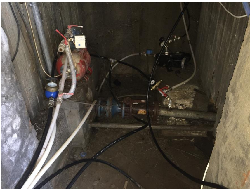
Φωτ.32: Εσωτερική λήψη του Βανοστασίου του Αντλιοστασίου Κατσέλη. Διακρίνεται ο καταθλιπτικός αγωγός (σιδηροσωλήνας Φ90μμ) που εξέρχεται από τον υγρό θάλαμο της Δεξαμενής και οδεύει προς τον οικίσκο του Γενικού Πίνακα Χαμηλής Τάσης για να συνδεθεί με τον πλαστικό αγωγό Φ140μμ (PVC) κλάσης 16atm. Στη λήψη από αριστερά προς τα δεξιά απεικονίζονται η βαλβίδα αντεπιστροφής ελαστικής έμφραξης, η βάνα πεταλούδας για την απομόνωση του αγωγού και φλαντζωτό τμήμα Χ/Σ για τη σύνδεση του με το σιδηροσωλήνα Φ90μμ
