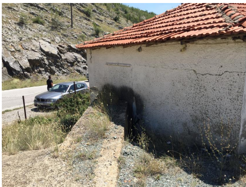
Φωτ.48: Εξωτερική άποψη του Αντλιοστασίου Σφαγείων ΝΑ του οικισμού της Σιάτιστας, σε απόλυτο υψόμετρο εδαφικού αναγλύφου της τάξης των 807,0μ όπου καταλήγει, ο υφιστάμενος αγωγός Φ140μμ, PVC, κλάσης 16α1m, μήκους 4970μ., που θα μεταφέρει το έλλειμμα υδροδότησης της Σιάτιστας (14,57l/sec) από το Α/Σ Κατσέλη (Λήψη από τον περιβάλλοντα χώρο του Α/Σ. Διακρίνεται αριστερά της λήψης η ασφαλτοστρωμένη οδός που συνδέει την Μπάρα με τον οικισμό της Σιάτιστας)
