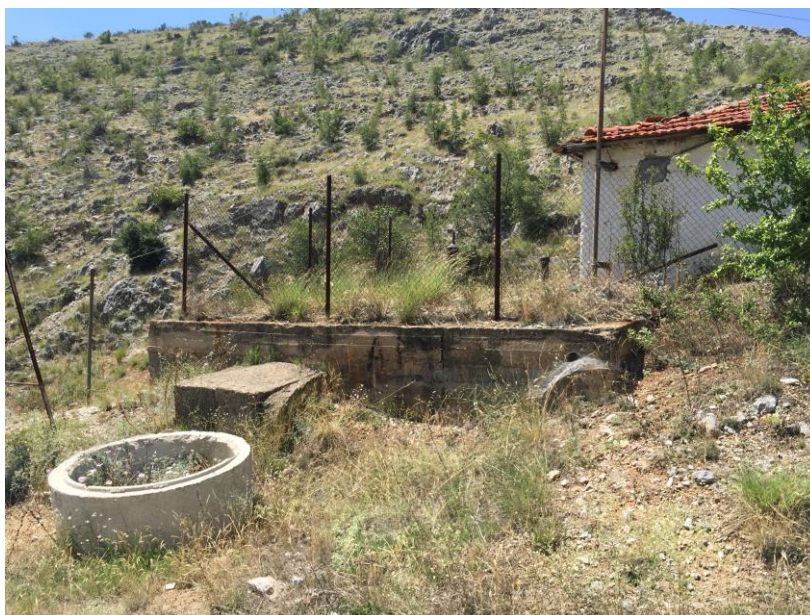
Φωτ.49: Εξωτερική άποψη του οικίσκου του Αντλιοστασίου ων Σφαγείων ΝΑ του οικισμού της Σιάτιστας, σε απόλυτο υψόμετρο εδαφικού αναγλύφου της τάξης των 807,0μ όπου καταλήγει, ο υφιστάμενος αγωγός Φ140μμ, PVC, κλάσης 16ατμ, μήκους 4970μ., που θα μεταφέρει το έλλειμμα υδροδότησης της Σιάτιστας (14,57l/sec) από το Α/Σ Κατσέλη και της Δεξαμενής αναρρόφησης του Αντλιοστασίου. (Λήψη από την ασφαλτοστρωμένη οδό που συνδέει την Μπάρα με τον οικισμό της Σιάτιστας. Διακρίνεται και η μεταλλική συρματοπερίφραξη του Αντλιοστασίου)
