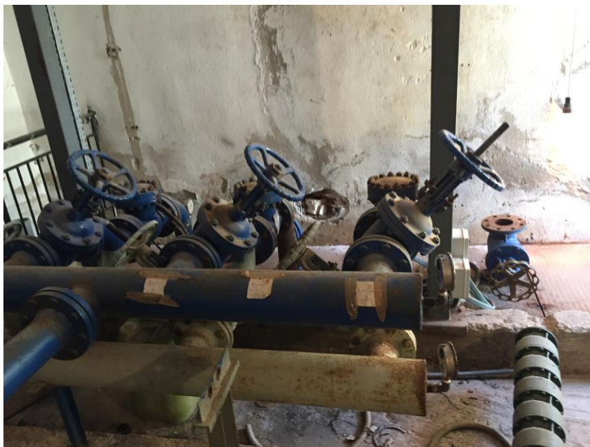
Φωτ.55: Άλλη εσωτερική άποψη των υδραυλικών διατάξεων των καταθλιπτικών αγωγών μεταφοράς νερού από το Α/Σ Σφαγείων (υψόμετρο 807μ.) στην Δεξαμενή Δ5 της Σιάτιστας (υψόμετρο 980μ.) για την κάλυψη της υψηλής ζώνης και του υπόλοιπου οικισμού. Διακρίνονται οι συλλέκτες και οι δικλείδες ελαστικής έμφραξης επί αυτών. Στα δεξιά της λήψης διακρίνεται και εφεδρική αντλία βαθέων φρεάτων εκτός λειτουργίας (εκτός της Δεξαμενής αναρρόφησης)
