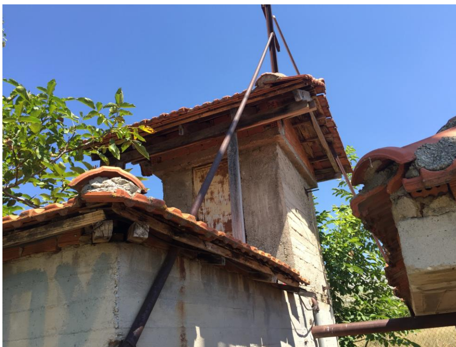
Φωτ.24: Εξωτερική κοντινή άποψη της Δεξαμενής αναρρόφησης και του οικίσκου ελέγχου και συντήρησης της Δεξαμενής άνωθεν αυτής, αριστερά της λήψης. Στα δεξιά της λήψης διακρίνεται η κεραμοσκεπή του οικίσκου του Γενικού Πίνακα Χαμηλή Τάσης.
