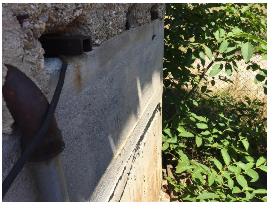
Φωτ.31: Κοντινή λήψη του περιμετρικού τοιχείου της Δεξαμενής αναρρόφησης. Διακρίνονται τα μεταλλικά στηρίγματα ανάρτησης του υφιστάμενου αντλητικού συγκροτήματος εντός της Δεξαμενής καθώς και ο πιεζομετρικός σωλήνας που διέρχεται εντός του υποκείμενου βανοστασίου της Δεξαμενής.
