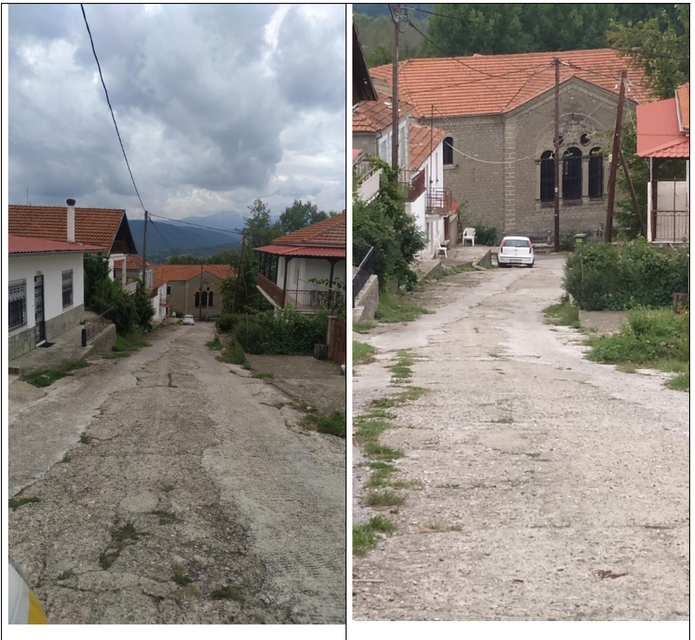
Εικόνες 1,2: Άποψη του δρόμου στο σημείο που χρήζει παρέμβασης
