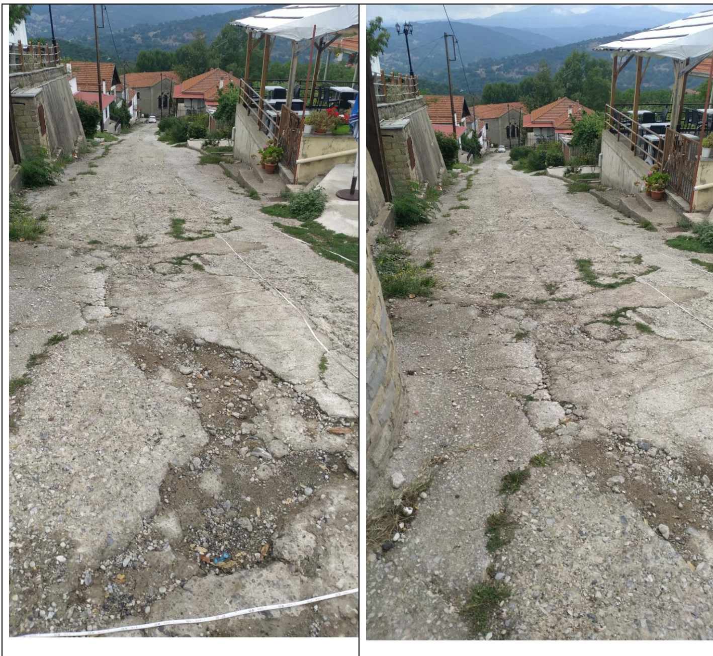
Εικόνες 3,4: Άποψη του δρόμου στο σημείο που χρήζει παρέμβασης
